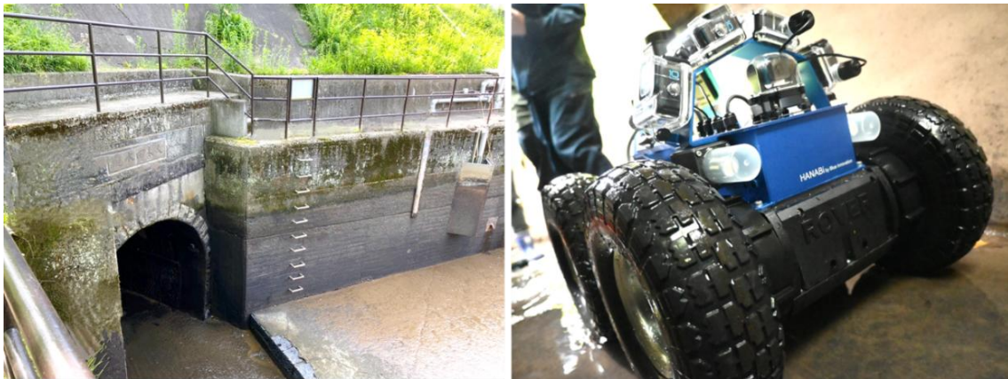
東北電力 人来田発電所の導水路(左)と点検用 AGV(右)
