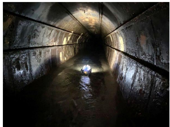
自動走行中の点検用 AGV
